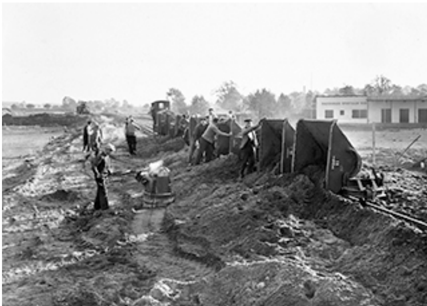
Abb. 2: Reichsautobahn im Bau 1937 in Radeburg (Sachsen), Errichtung eines Damms (4 Meter Höhe) in Handarbeit (SLUB/Deutsche Fotothek, Walter Möbius)
